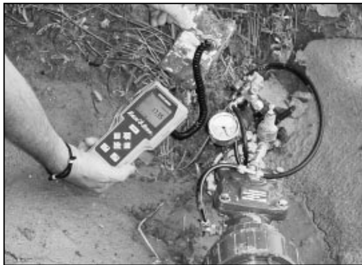
Este módulo de control había sido enterrado por 2 semanas debido a inundaciones. La comunicación infrarroja con el transmisor de campo aún funcionaba.
